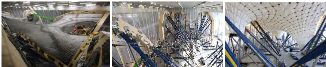
Figure 3. Sistema de formaleta híbrida Nest-Hilo empleando una red de cables y una membrana; fotos de Naida Iljazovic del grupo de investigación BLOCK en Zúrich
